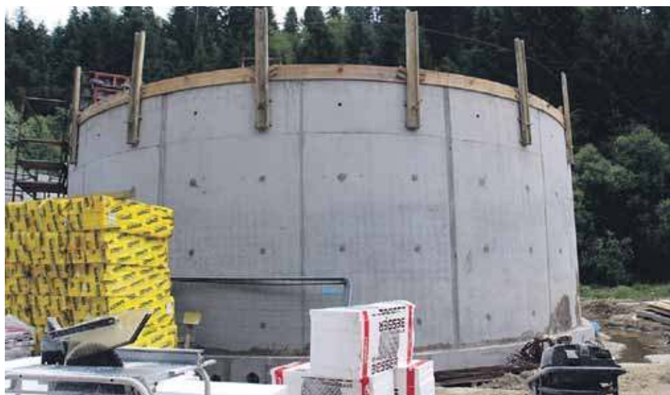
Stacja uzdatniania wody w Mizernej będzie kosztować 7 mln zł.
