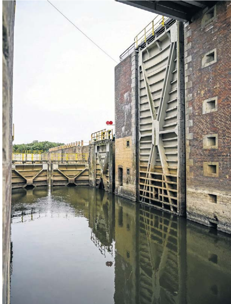
Potężne wrota przeciwpowodziowe chronią okolicę przed wysokimi stanami na Wiśle. Obecnie to nie grozi
