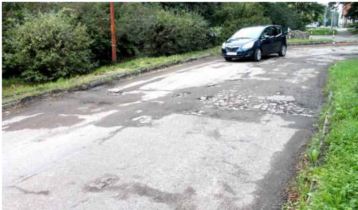
Na ulicy Andersa powstała ogromna dziura i wybój w drodze. Bardzo trudno jest po niej przejechać autem
