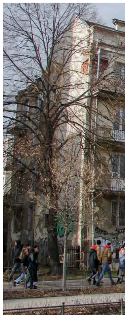
Kamienica przy ul. Grójeckiej 184 i jej zniszczona elewacja
