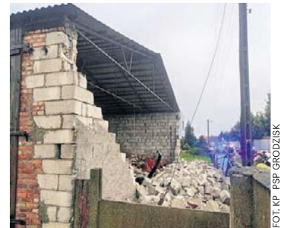
Pustaki z zawalanej ściany spadły na chodnik i ulicę
