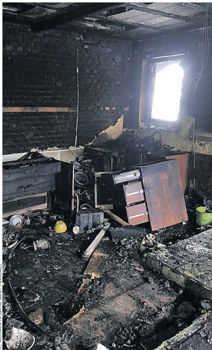
Remont może wynieść nawet 300 tys. zł
