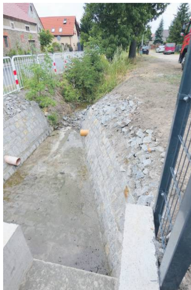
Tak wygląda odpływ z osadnika
