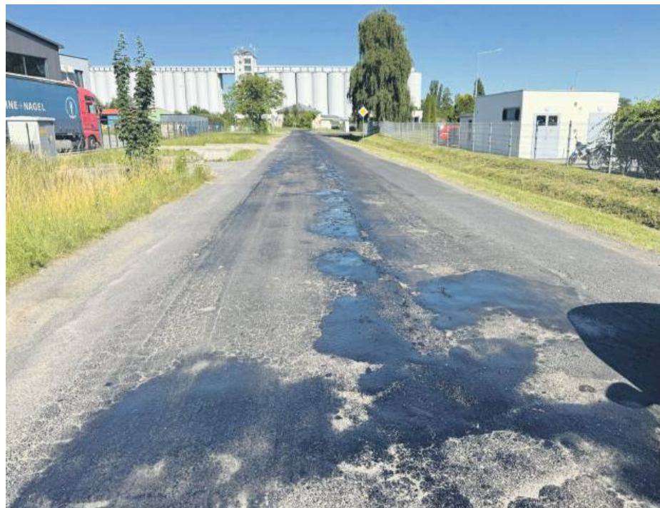
Z powodu upałów z drogi w Pęczu zaczęła wyciekać emulsja asfaltowa. Fot. Tadeusz Głowa
