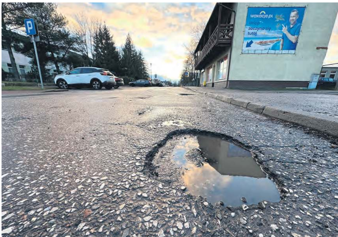
Ulica Piastowska – łata na łacie – wygląda fatalnie, ale i potrafi być niebezpieczna przez niespodzianki w postaci głębokich dziur. Piastowska od lat prosi się o remont. Regularnie interweniują mieszkańcy, a ich skargi docierają do „Tygodnika”. To ulica o wyjątkowym charakterze komunikacyjnym w Tucholi. Przy niej jest największa tucholska szkoła podstawowa i inne placówki oświatowe, a oprócz tego liczne sklepy i duży market. Jej „rozbudowa”, podobnie jak Kościuszki i część Grunwaldzkiej, znalazła się w planie inwestycji na 2024 rok. Fot. Piotr Paterski
