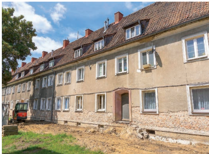
Na nowe wymieniane będą wszystkie okna, remont przejdą dachy. W mieszkaniach poprawi się komfort termiczny.
