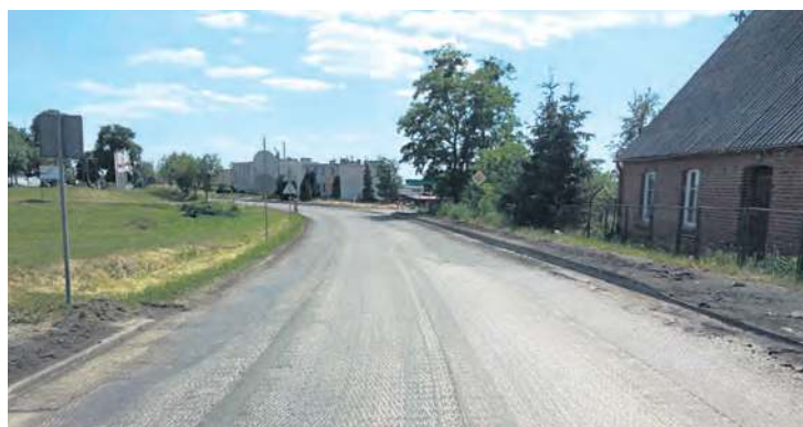
Sfrezowany odcinek drogi w Łyskowie.
