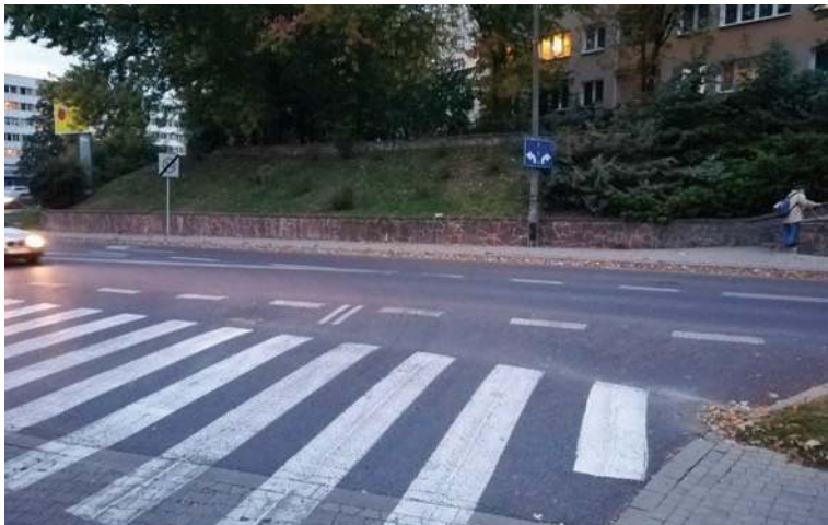
Zapadnięta jezdnia na ulicy Kuronia
