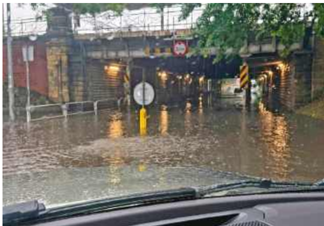
■ Zalany wiadukt przy dworcu kolejowym po lipcowej ulewie
