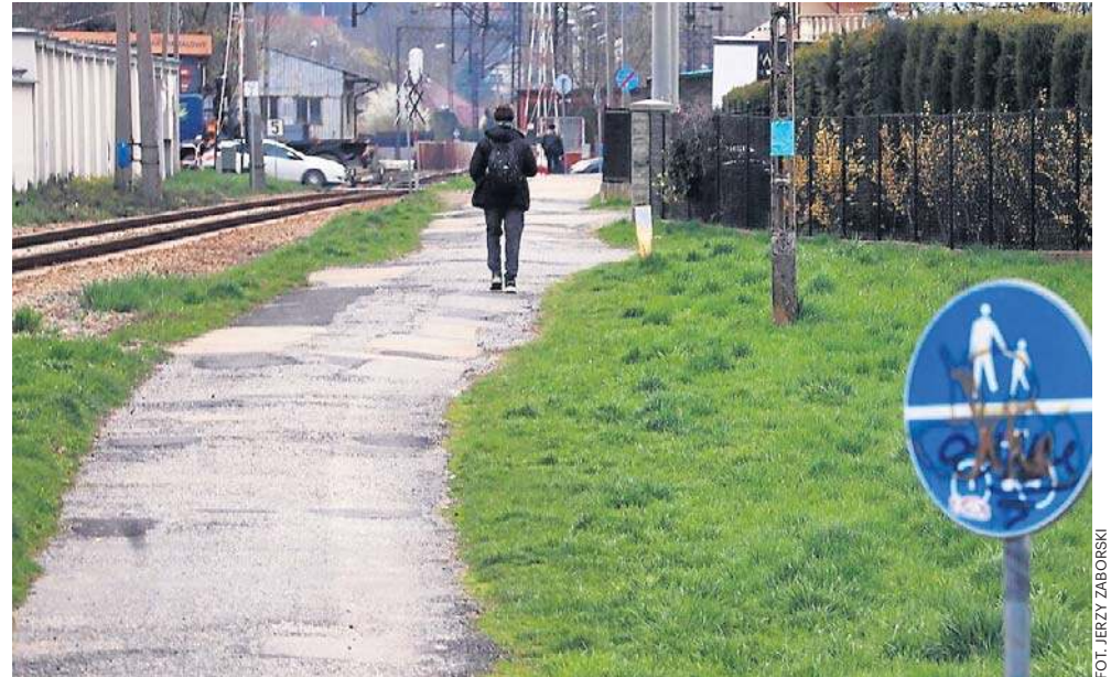
Będący w opłakanym stanie trakt dla pieszych w Kętach ma być dostosowany do dzisiejszych standardów. Gmina Kęty musi jednak pozyskać ten teren od PKP SA
