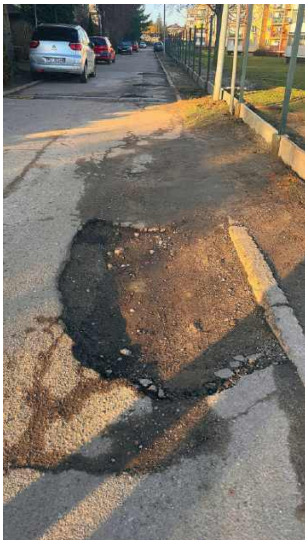
Tak wygląda droga należąca do wspólnoty przy Płockiej 30
