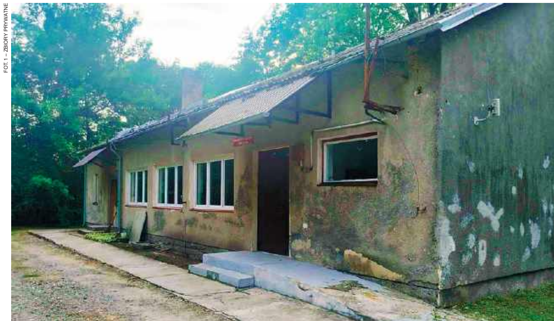
Budynek szkoły znajduje się w fatalnym stanie technicznym
