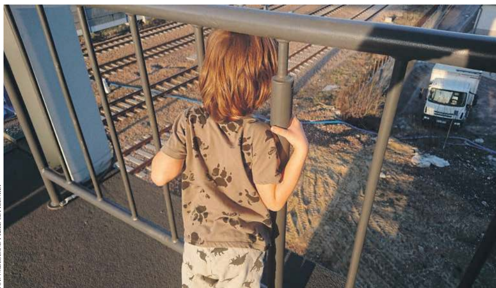
(e) Pręty balustrady są źle rozmieszczone, co może być niebezpieczne
