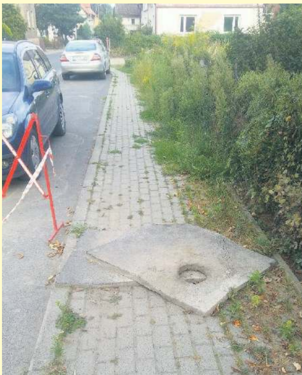
Idąc lub jadąc w nocy chodnikiem w pobliżu Urzędu Pocztowego w Przewornie można się przewrócić na tych przeszkodach
