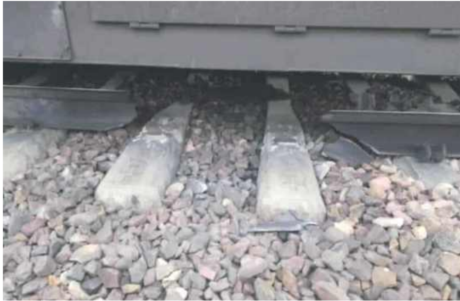
Wyrwa w torach miała ok. metra
