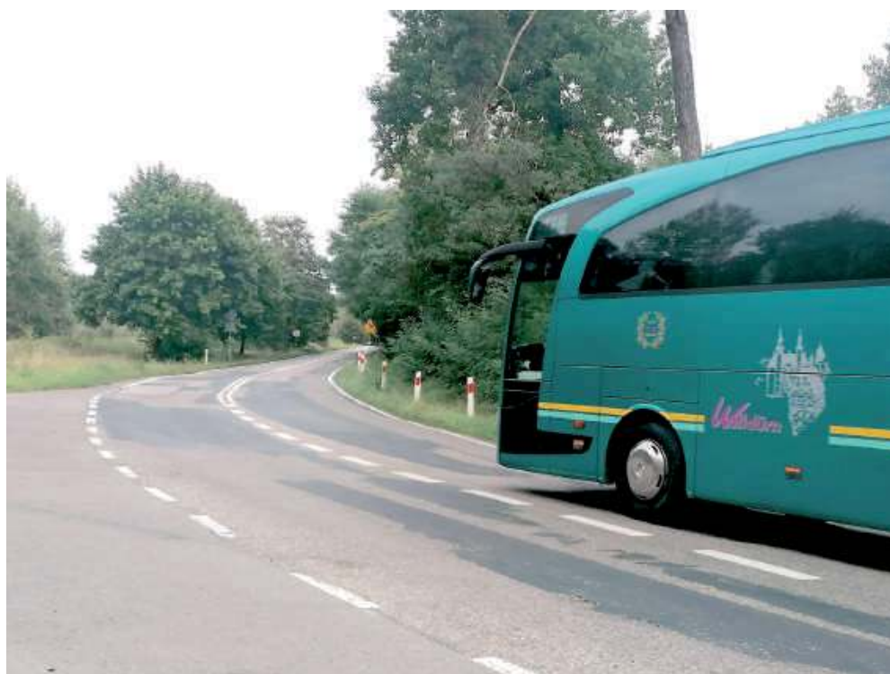
Droga wojewódzka 832 na odcinku z Poniatowej do Woli Rudzkiej woła o pomstę do nieba od dłuższego czasu. Nawierzchnia jezdni w wielu miejscach jest uszkodzona, nierówna. Najgorsze dla kierowców są głębokie koleiny
