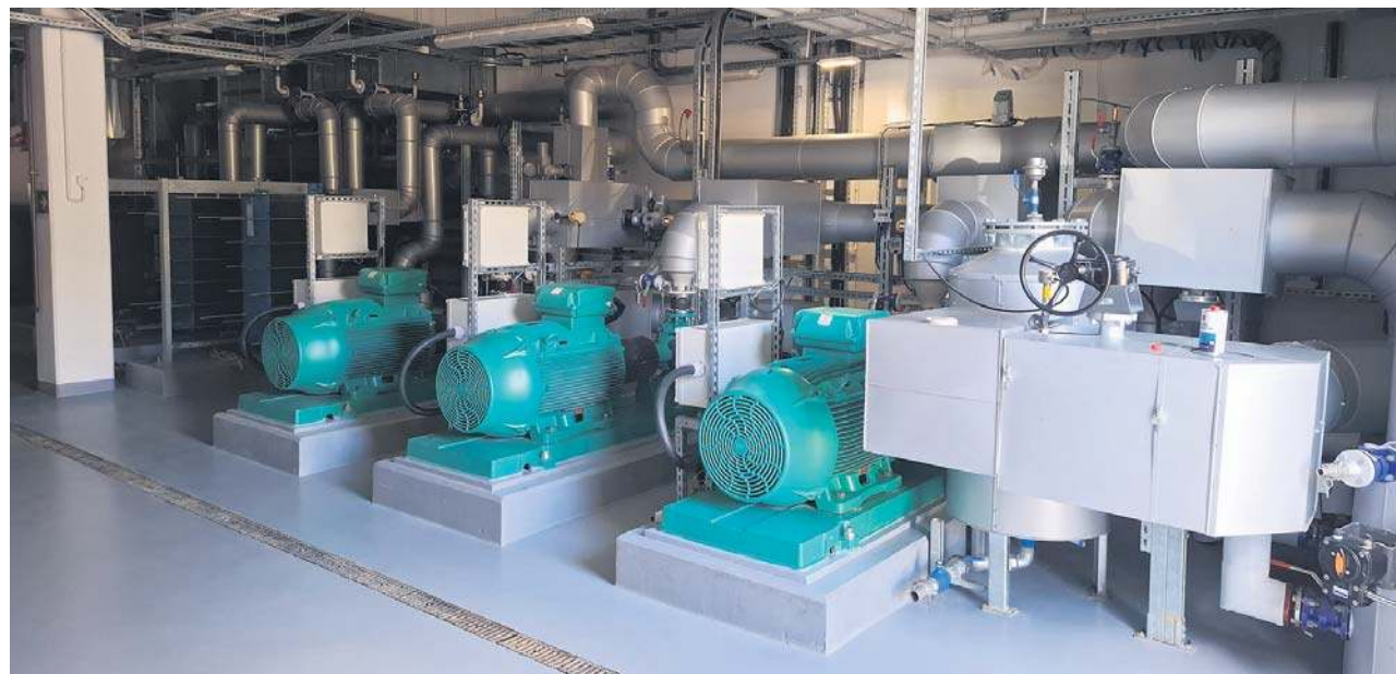
Moduł silników gazowych do wytwarzania energii elektrycznej i ciepła, MPEC Tarnów.
