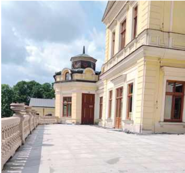
Choć przed ekipą remontową pozostało jeszcze kilka miesięcy pracy, już teraz widać znaczące postępy
