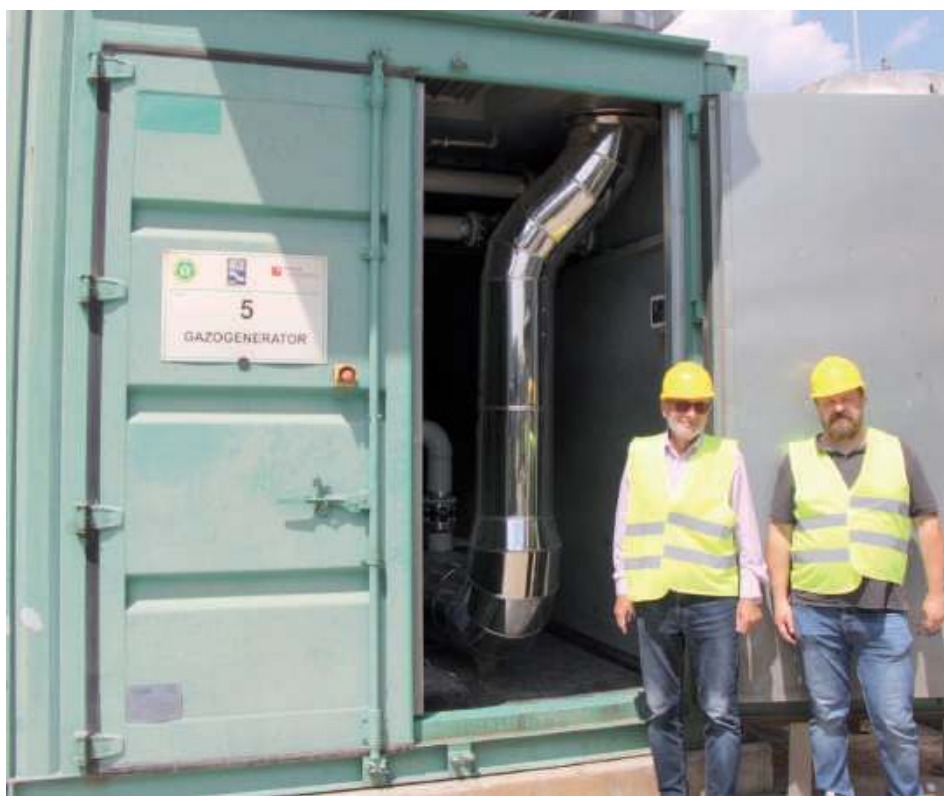
Radosław Szumiec (z lewej) i dyrektor sortowni w Wólce Rokickiej Krzysztof Grzegorzczak przy generatorze biogazu
