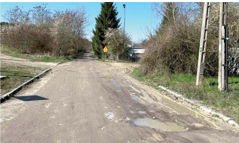
Tak na chwilę obecną wygląda jedna z dróg w gm. Kazimierz Dolny. Po modernizacji pojawi się tu nowa nawierzchnia
