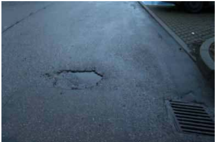
Nie tylko na miejskich ulicach występuje problem zanieczyszczonych czy uszkodzonych dróg
