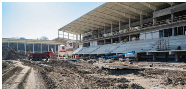
Konstrukcja pnie się w górę, a prace wyraźnie przyspieszyły wraz z nadejściem wiosny.
