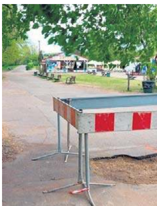
Wyrwy na głównym wjeździe na teren „Myślęcinka” będą załatwane
