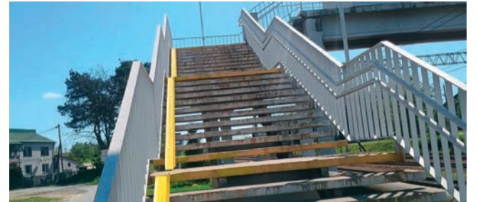
Na schodach kładki nad torami jest wciąż tylko jedna płoza. Tym samym nie można w praktyce tamtędy przejść z wózkiem
