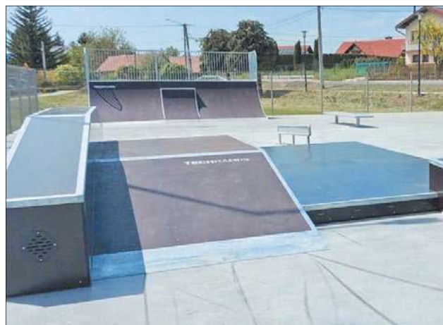
Projekt obejmuje budowę betonowej płyty z układem przeszkód i elementów małej architektury
