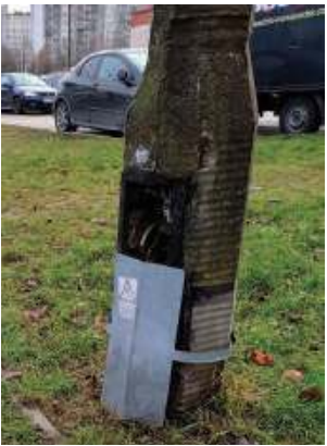
Taki widok przeraził naszego Czytelnika. Dzięki jego interwencji słupy już zostały zabezpieczone
