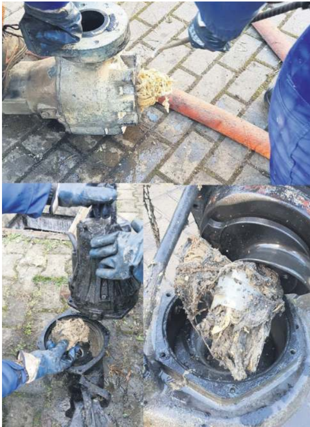
Do kanalizacji trafiają rzeczy, które nigdy nie powinny się tam znaleźć. Fot. PUK Tyszowce
