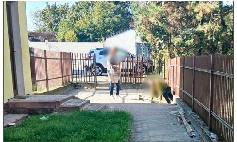
Żeby dostać się do sklepu część klientów wchodzi na plac budowy, a następnie czołga się pod ogrodzeniem.
