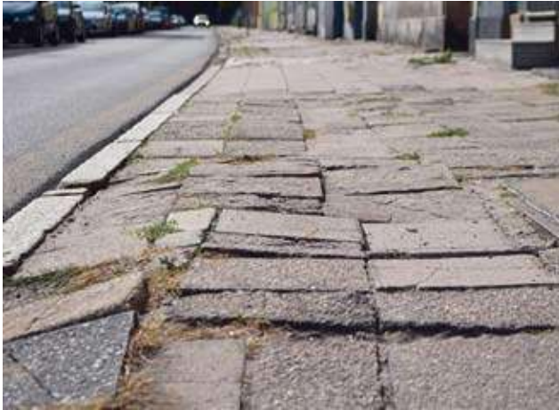
Chodnik na ul. Wesołej to zmore mieszkańców...
