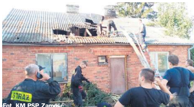
Fot. KM PSP Zamość W powiecie zamojskim wichura uszkodziła aż 38 dachów.
