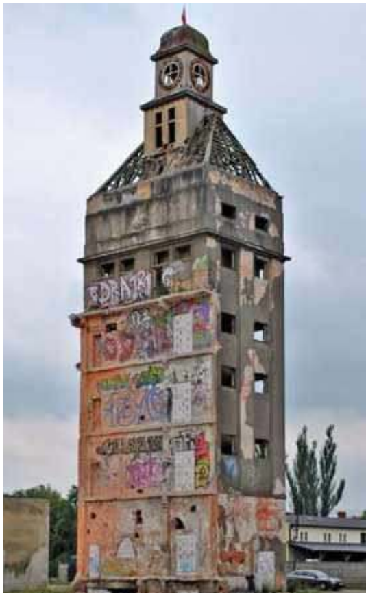
Fatalny stan techniczny wykluczył zachowanie wieży
