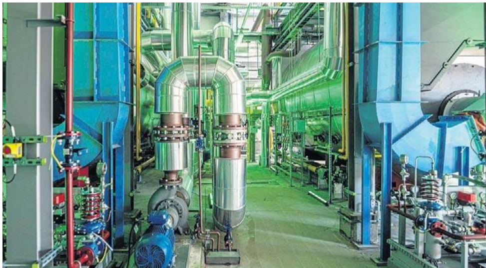
Elektrociepłownia PGE Energia Ciepła w Gdyni dekarbonizuje się sukcesywnie
