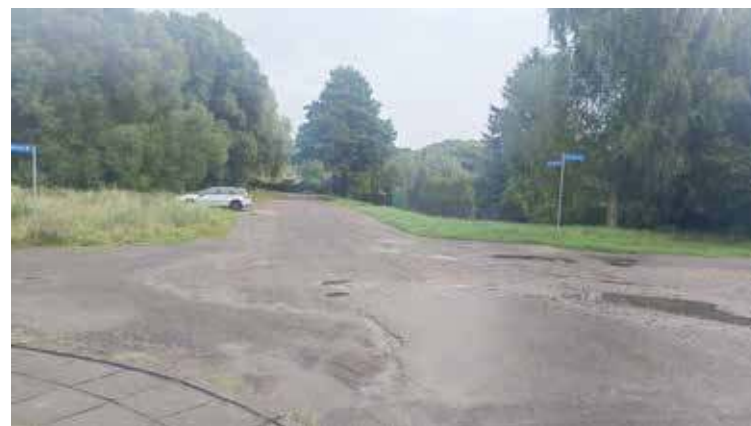
Asfalt na jezdni kończy się, zastąpiony ziemią
