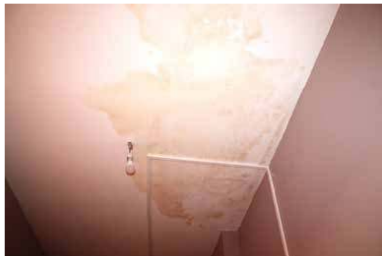
Na ścianie kuchni jest wilgoć powodująca nieprzyjemny zapach
