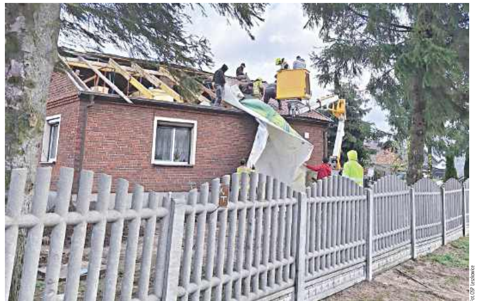
Strażacy zabezpieczyli dom w Tarkawicy w gminie Ostrówek, na którym burza zerwała dach
