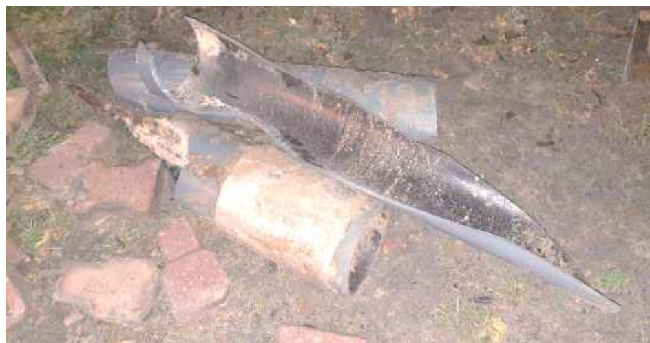
Awaria przy ul. Podleśnej została spowodowana pęknięciem podłużnym rurociągu
