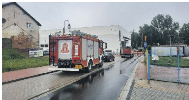
Straż pożarna musiała interweniować w sprawie zalanego placu budowy przy szkole podstawowej
