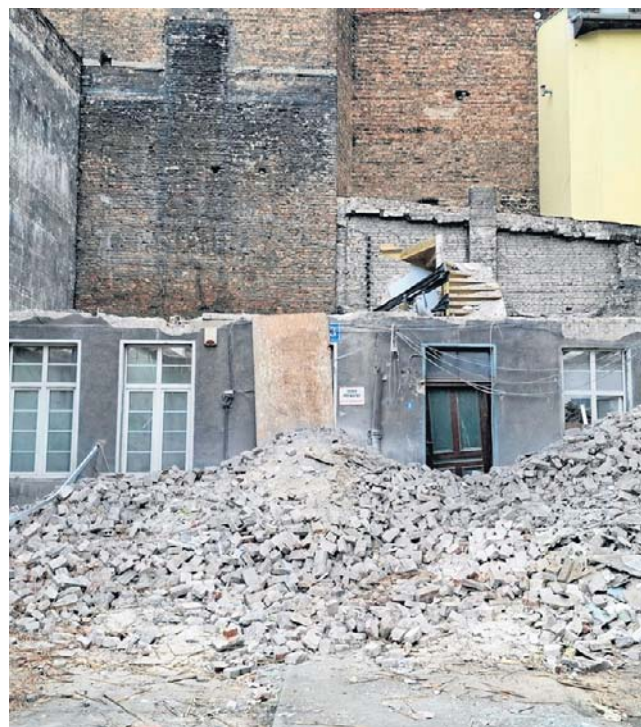
Ulica Sukiennicza 3. Z kamienicy zostały w zasadzie tylko żelazne schody
