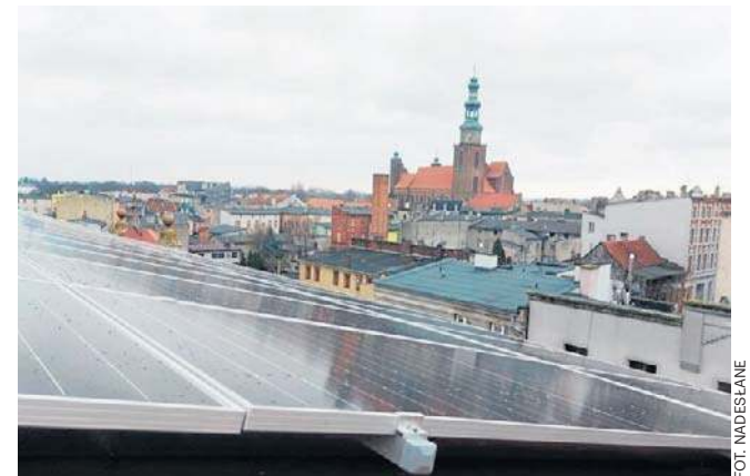
Fotowoltaikę z magazynem energii udało się zainstalować dzięki pozyskaniu dotacji przez powiat
