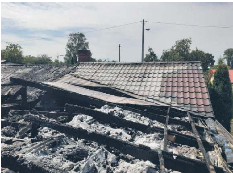
W wyniku pożaru budynek został zniszczony, nie da się w nim mieszkać
