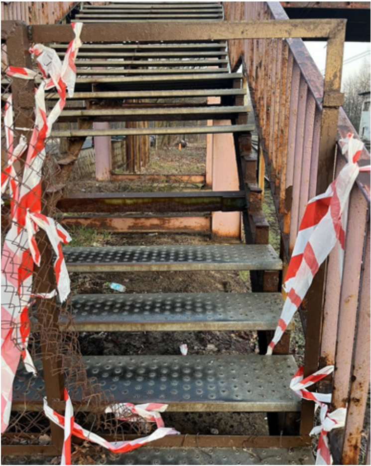
Brak stopni na kładce. Źródło: Maciej Stadnik, Fb
