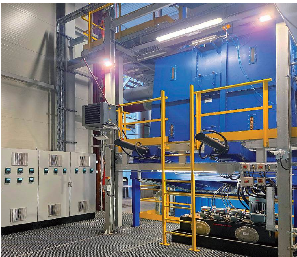
Widok ogólny instalacji kotła biomasowego KB2
