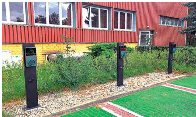
Stacje ładowania samochodów elektrycznych 3 x 22 kW
