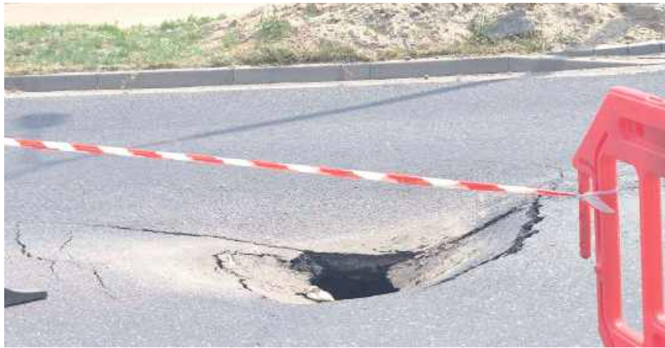
Powstałe zapadlisko na ulicy Staszica w Łęcznej
