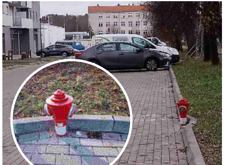
Hydrant- główny bohater
