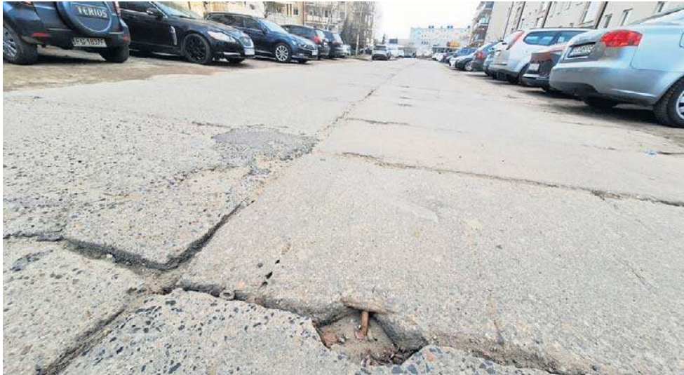
Ta dziś wygląda dojazd do bloków przy ul. Siedzikówny-Inki. Droga z płyt ma już około dwadzieścia lat
