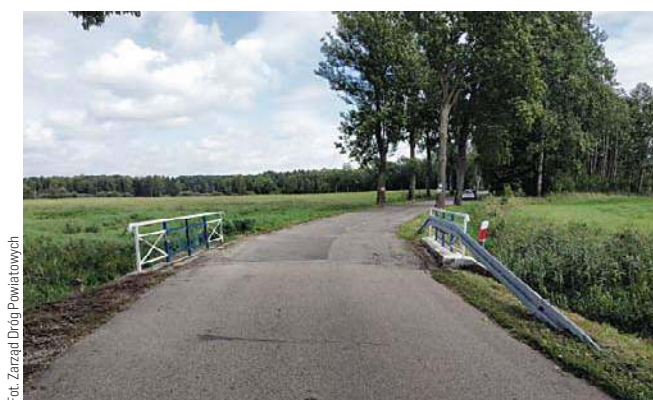
Złodzieje zabrali stalowe zabezpieczenia na moście niedaleko wsi Szczepanki
