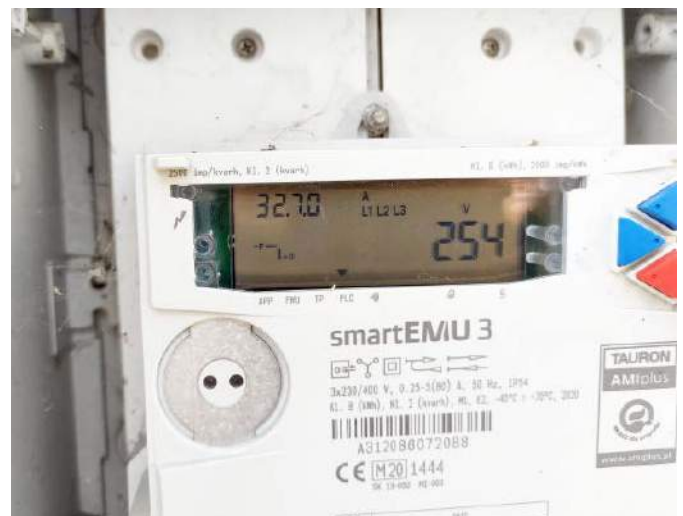
Fotografia 5. Napięcie sieci NN w słoneczne popołudnie, podczas tzw. walki falowników
