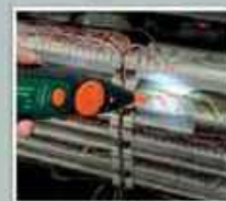
podświetlenie miejsca pracy
